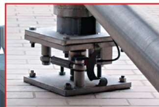
Sistema de pesaje de silos (células ATEX + indicador)
